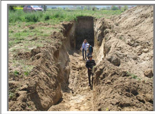
Şekil 11.29. T-4 nolu fay kazısı çalışmasından görünümler.
