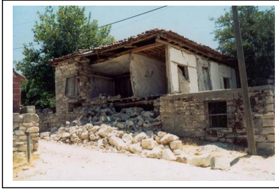
Şekil 14. Bölmekeya'da tek katlı yığma yapıda gelişmiş hasardan görünüm.
