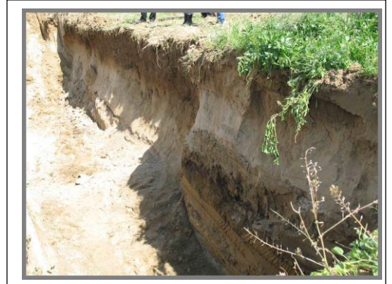
Şekil 11.30. T-4 nolu fay kazısı güneydoğu duvarında fay izinden görünümler.
